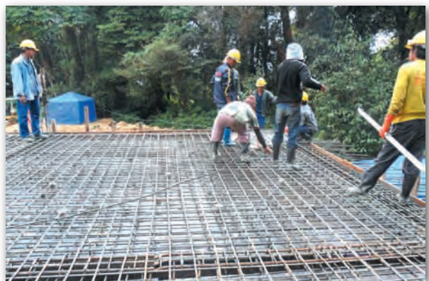
งานทำพื้นคอนกรีตเสริมเหล็ก ชั้น 1 ของอาคารควบคุม
