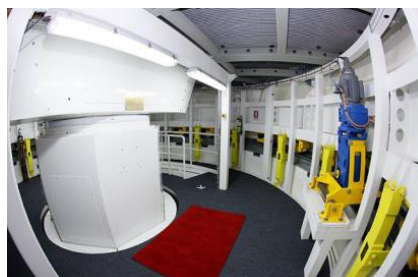
ชั้นที่ 2 ติดตั้งมอเตอร์สำหรับขับเคลื่อนกล้องโทรทรรศน์ 1 ตัว และโดม 2 ตัว
