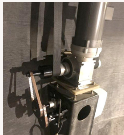
เซนเซอร์วัดตำแหน่งฝาโดม ติดตั้งที่ตัวมอเตอร์ควบคุมฝาโดม
