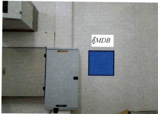
รูปถ่ายบริเวณที่ติดตั้งตู้เมนเบรกเกอร์
