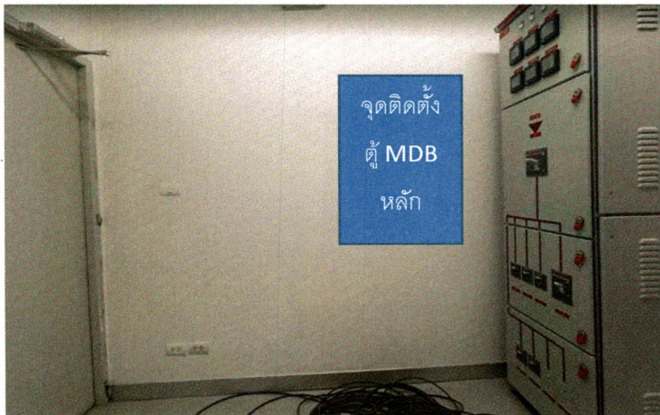
ภายในห้องควบคุมระบบไฟฟ้า
